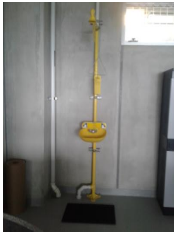
Figura 6.2. Ducha y lavaojos ubicada en el laboratorio.
